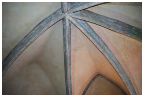
Klenby po restaurování, vlevo omítka z počátku 20. století, vpravo restaurátorský provedený odkryv na barokní vrstvu
